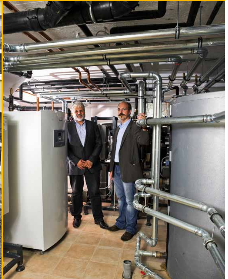
Erdwärmepumpe mit Pufferspeicher
